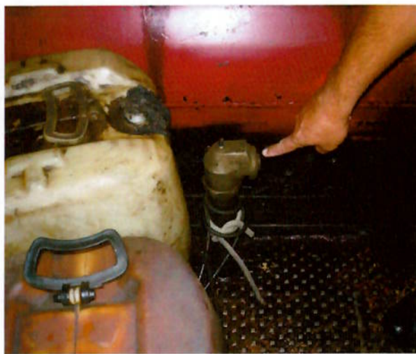
Figura 26 – Fixação inadequada do acesso ao tanque de combustível e armazenamento irregular em recipientes plásticos. Fonte: IPEM-SP
